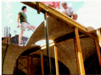
16 Firmen waren am Bau beteiligt. Die Baufläche liegt bei 400 qm, der umbaute Raum wird mit 5.000 m 3 angegeben bei 2.000 m 3 Erdaushub (Fotos: Adler)
