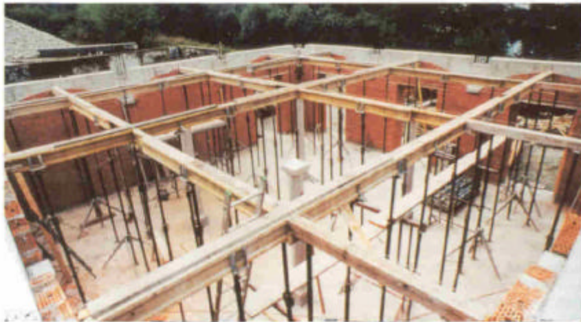
Vor dem Einbau der Gewölbeelemente werden die Säulen aufgestellt und Konsolen eingesetzt. Vorübergehend werden Hilfsgerüste errichtet, die das Gewölbe an den Schnittstellen der Elemente unterfangen.
